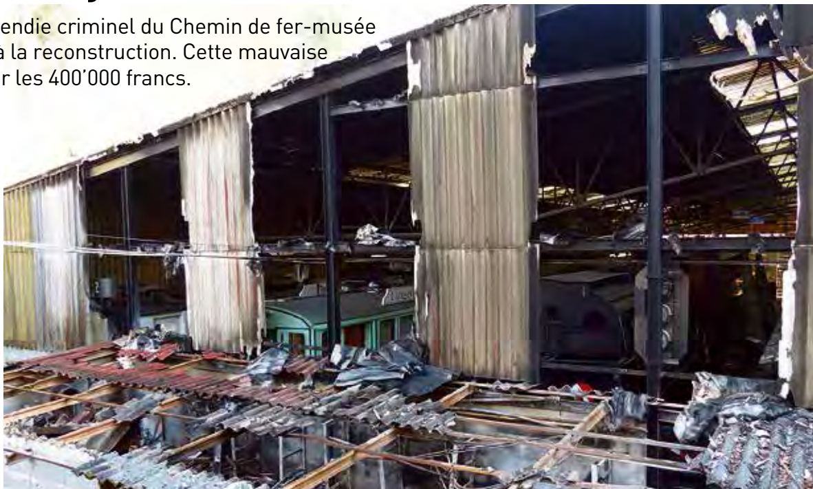
Le feu a été bouté en huit endroits et a totalement détruit la halle des pièces de réserve ainsi qu'un wagon dont la restauration était à bout touchant.
